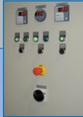
Schaltschrank mit SPS
